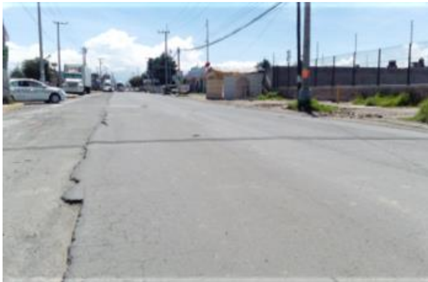
Ilustración 6 Estado actual de la Avenida
