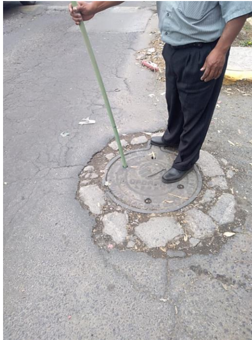
Ilustración 8 Estado actual de la Avenida
